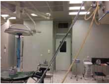
Bild 5: Russischer Operationsaal mit installierten Potok-Einheiten
